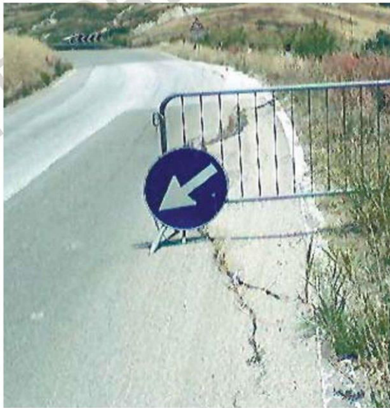
La Sicilia perde i fondi per lavori alle strade dissestate
